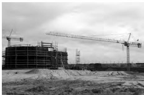
Estação Elevatória Bento Gonçalves e do Lavradio - as estações de maior dimensão
